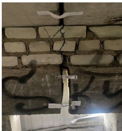
Рис. 1. Раскрытие деформационного шва в ростверке фундамента здания ТИРа (фото из архивов Научного центра изучения Арктики)
