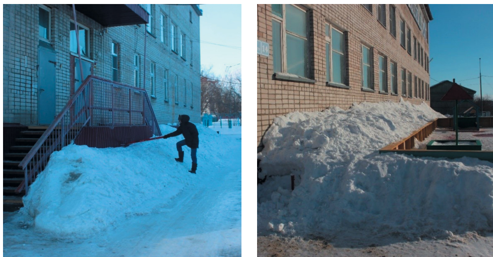
Рис. 16. Недопустимое складирование снега по периметру здания, завал вентиляционных отверстий
