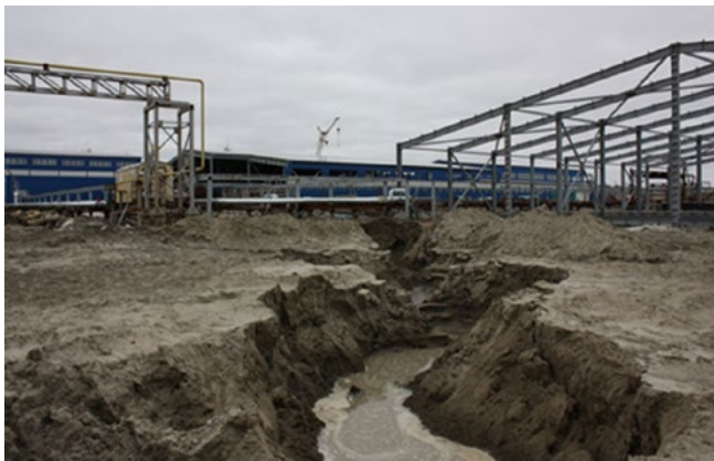
Рис. 1. Нарушение ландшафтов при строительстве площадки под инженерные объекты газодобывающего комплекса и сопутствующее развитие водно-эрозионных процессов
