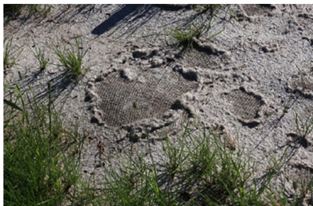
Рис. 9. Признаки разложения покрытия БиоСТЭК-Грин 45 на участке рекультивации 2015 г. без засыпки землей (по состоянию на 2016 г.)
