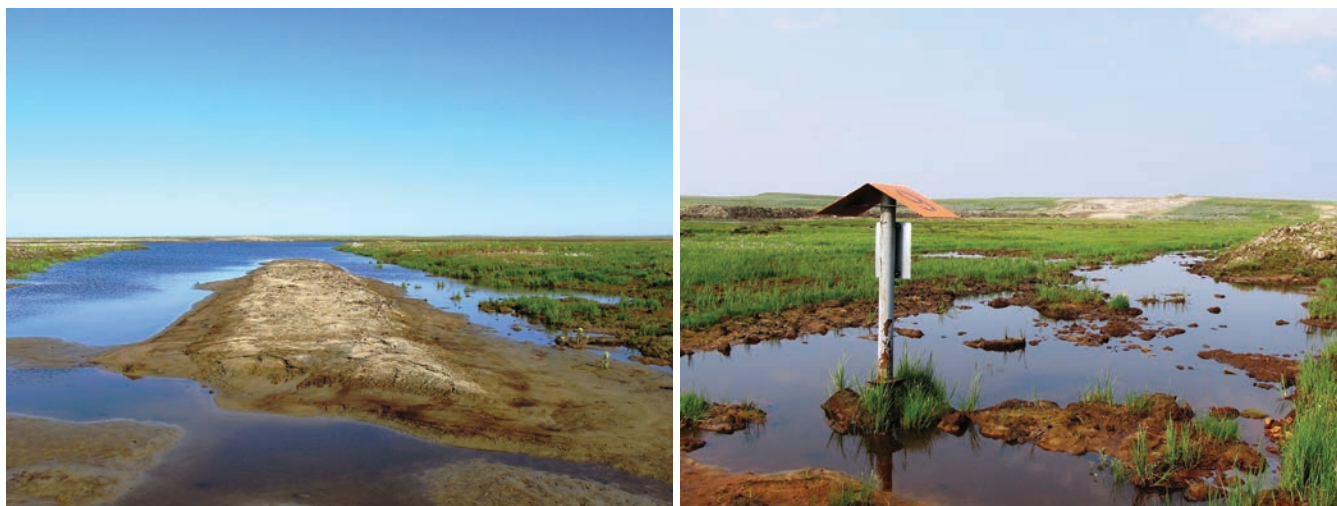
Рис. 2а, 2б. Размыв и подтопление валика обратной засыпки газопровода на Ямале
